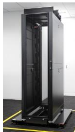
画像 3) 免震テーブルに搭載されたラック
